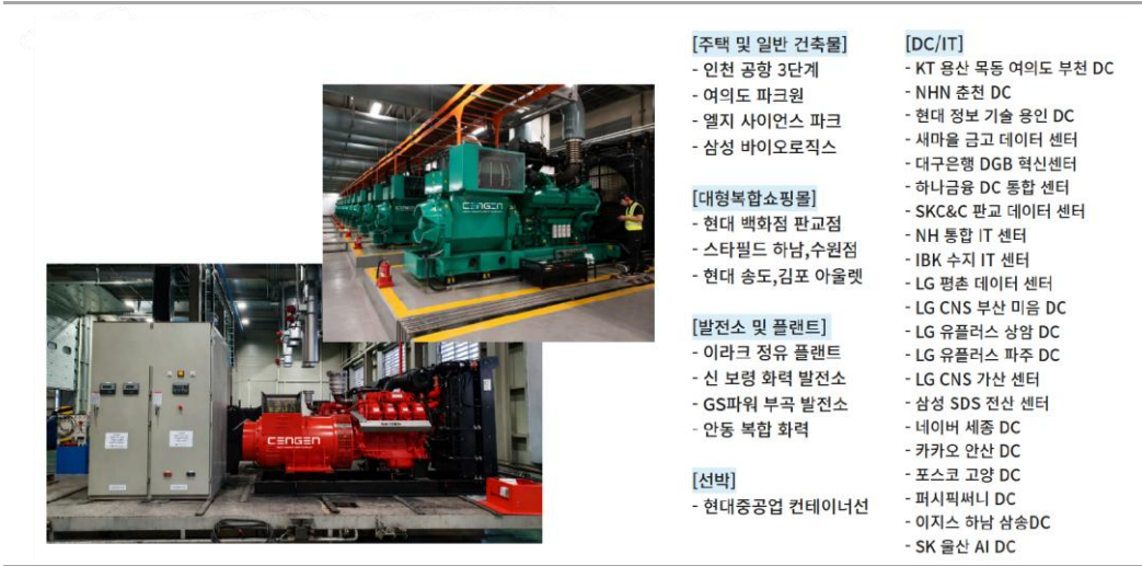
Figure 4. 비상발전기 공급 레퍼런스
